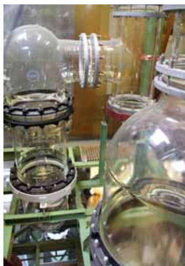
Gläserne Reaktoren und Leitungen sind die Besonderheit dieser Anlagenerweiterung
